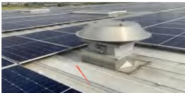
通风口遮挡光伏板
