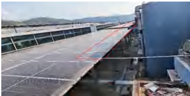
光伏组件部分被遮挡
