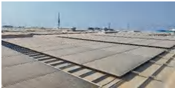
光伏组件积灰严重
